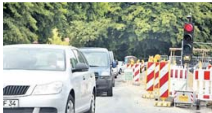
Eine Ampel regelt den Verkehr in Dungelbeck. Wegen des Umbaus der Ortsdurchfahrt kann es zu langen Wartezeiten kommen. cb
